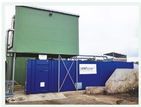
Digestāta separēšanas iekārta SIA „Pampāļi”.
