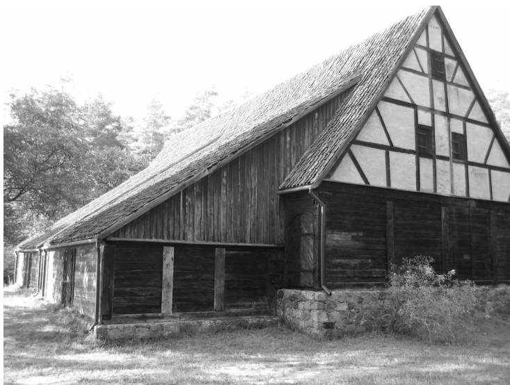
1. att. Ostas noliktava, Kurzeme, Liepāja, 1697. g.; objektā identificētas deviņas koksnes sēņu sugas. Fig. 1. Harbour warehouse, Kurzeme, Liepāja, 1697; nine fungal species were identified in the object.
